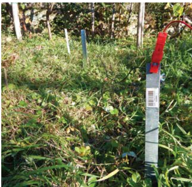
Ozemljitev naj bo sestavljena iz vsaj treh pocinkanih cevi (Foto: Tomaž Berce)
